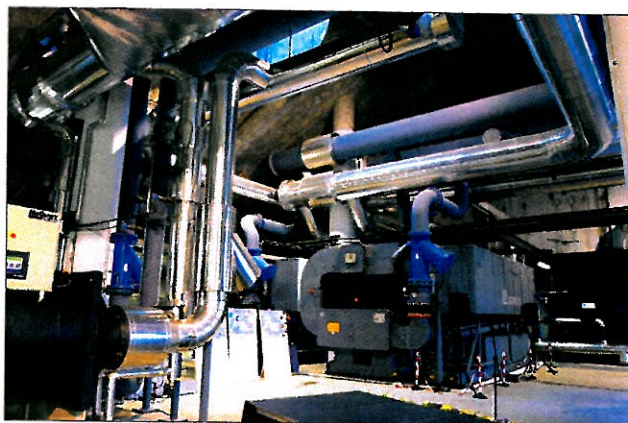
Figura 32.2. Planta de generación de frío.
