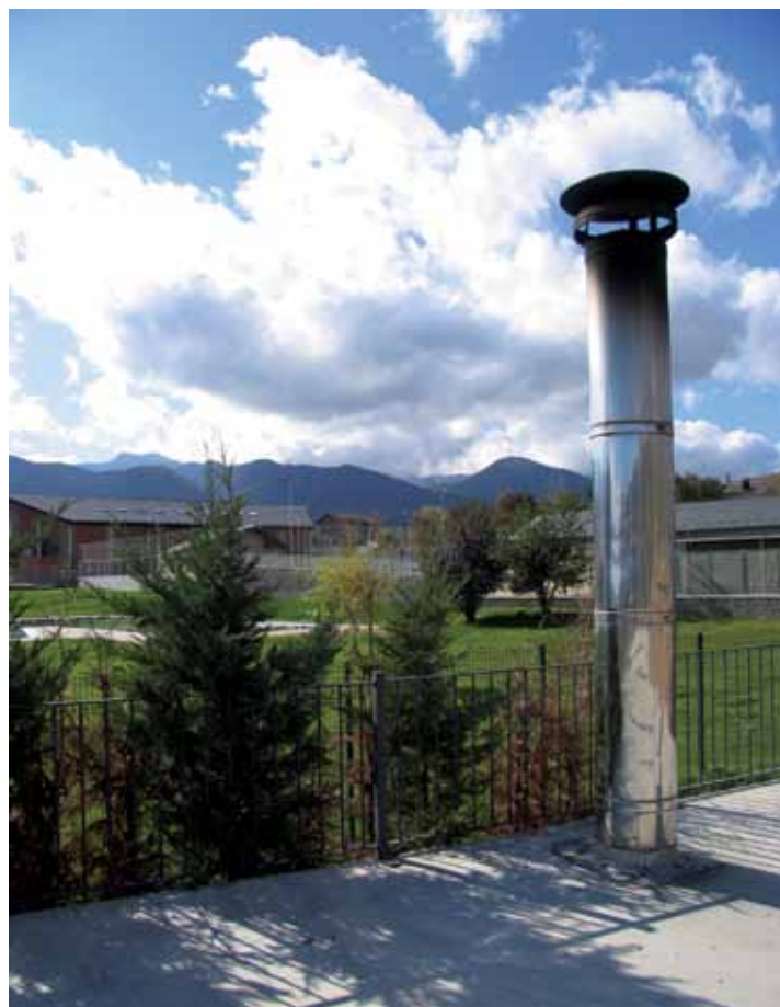
Sortida de fums de la caldera de biomassa
