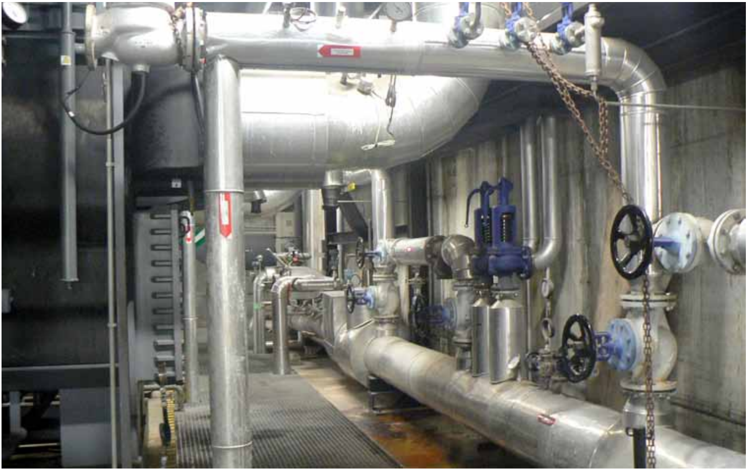
Instal·lacions de Districlima a Barcelona
