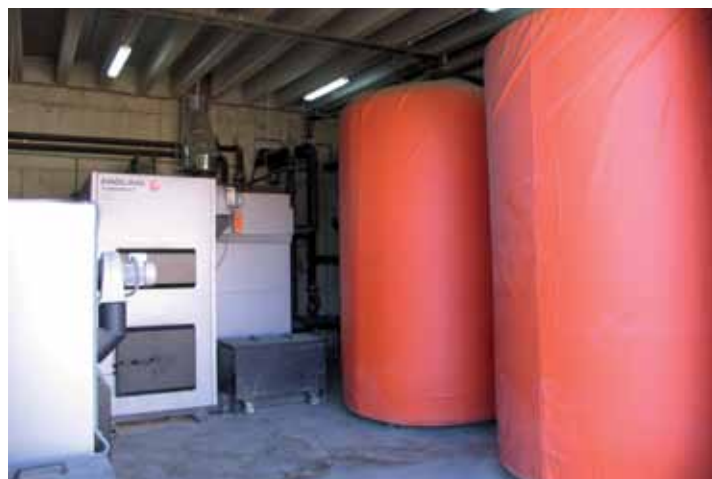
Instal·lacions de la xarxa centralitzada de biomassa forestal
