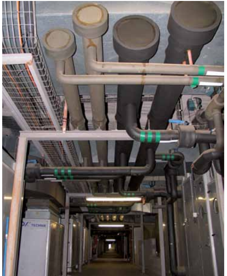
Instal·lacions del Centre de Convencions de Barcelona
