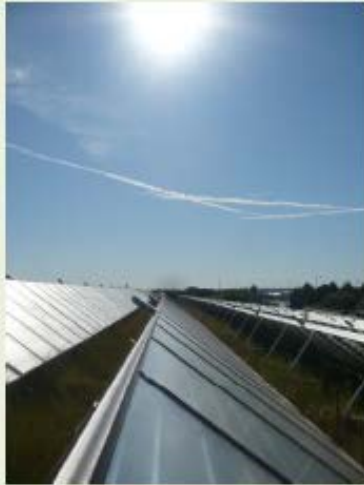
Hillerød 3 000 m 2 / 2,1 MW
