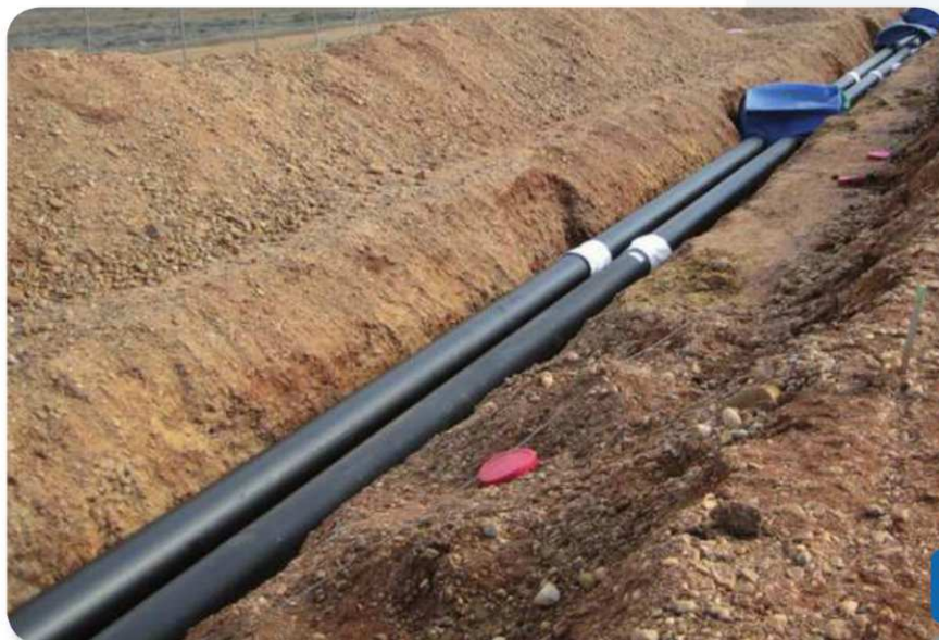
Tubería de impulsión y retorno de district heating District heating supply and return piping
